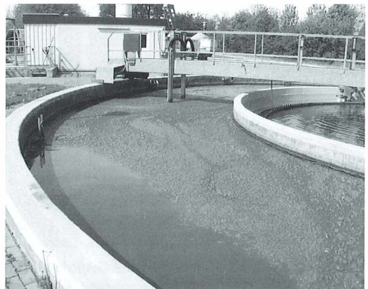
Abb. 1: Belebtschlammbecken einer Kläranlage mit Schaumbildung.
